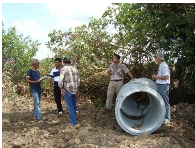
ภาพผนวกที่ 8 ท่อสำหรับระบายน้ำเข้าและออกจากแปลงปาล์มน้ำมัน
